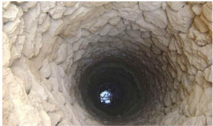
جدار الربط داخل البئر
